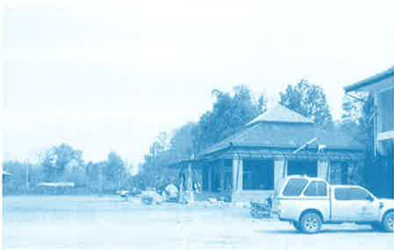
▶現在、図書館を建設中。この隣に小学校建設を希望している
