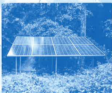
▲ポンプの動力となる太陽電池
