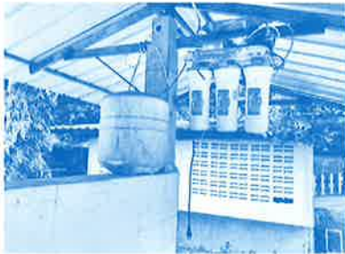
▲給水小屋の老朽化した水ろ過装置
